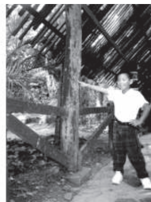
การเข้าทำลายโครงสร้างไม้ ใช้ประโยชน์ภายนอกอาคาร
