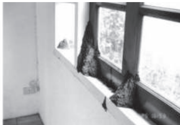
การเข้าทำลายของปลวกภายในอาคาร
